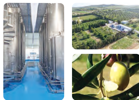
オイルタンク
